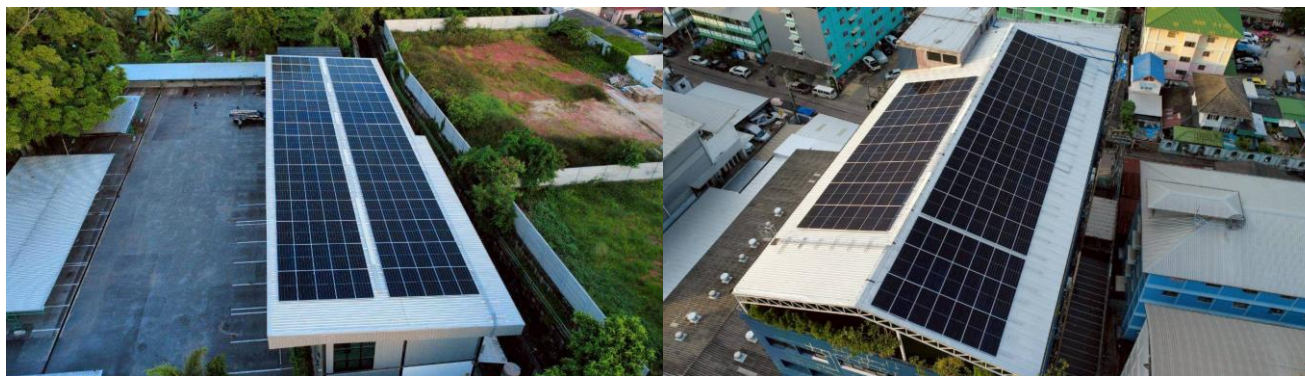
Solar Rooftop สำนักงานใหญ่
